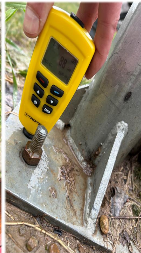
Stâlp iluminat cu elemente de prindere ruginite
