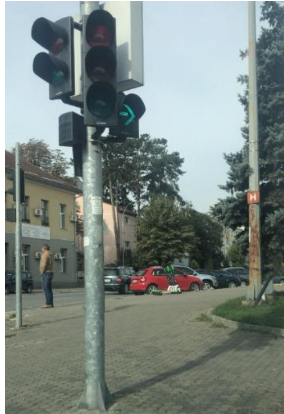
Stâlpi pentru semaforizare zincăți termic (stânga imaginii) și stâlp corodat (dreapta imaginii)
