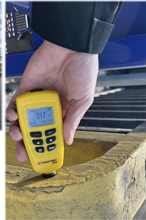
Balustradă cu strat de 217 micrometri de vopsea și urme evidente de revopsire și întreținere
