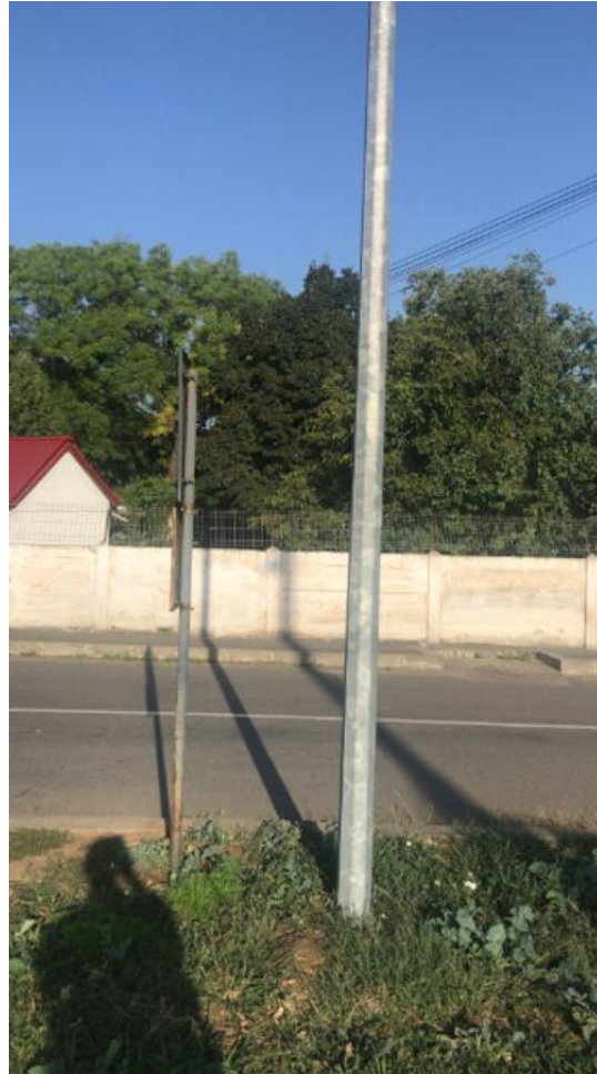
Stâlp vopsit corodat (stânga imaginii) /stâlp zincat termic (dreapta imaginii)
