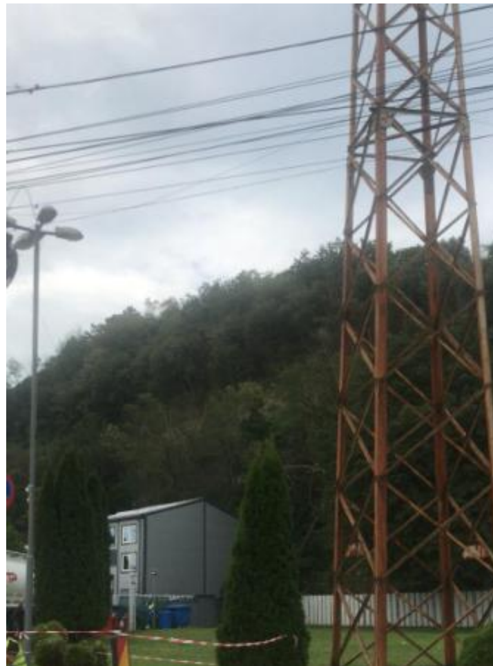
Stâlp de iluminat zincat termic (stânga imaginii) și stâlp corodat (dreapta imaginii)
