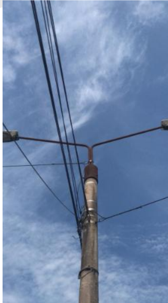
Console corpuri de iluminat corodate
