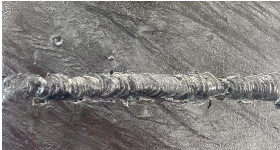
Fig. 18 Cusătura după zincare termică
