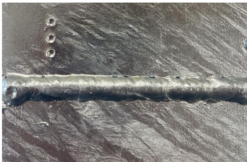
Fig. 24 Cusătura după zincare termică
