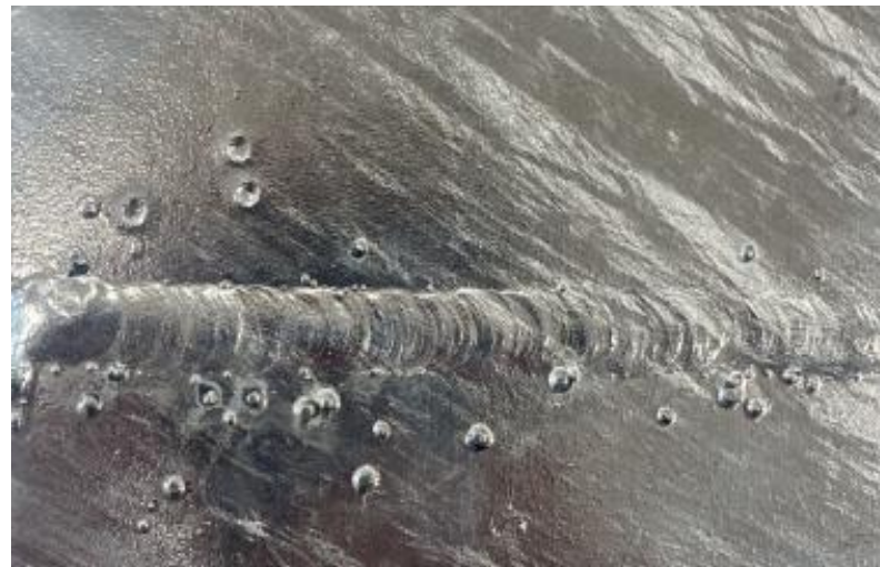
Fig. 12 Cusătura după zincare termică
