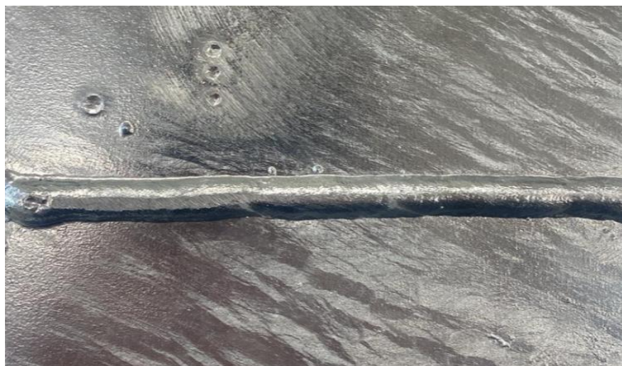
Fig. 15 Cusătura după zincare termică
