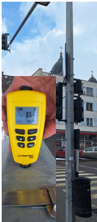
Stâlp de iluminat. Pentru mediul de corozivitate C3 (urban/industrial) grosimea stratului de zinc de 83 microni asigură protecție anticorozivă pentru minim 42 de ani fără întreținere (standardul SR EN ISO 1461:2022)
